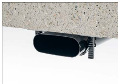
Flachkanal an der Kellerdecke
